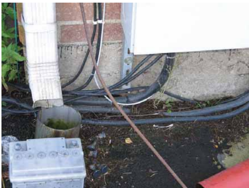
Kuva 9. Suojaamattomia kaapeleita pääkeskuksen alla.
