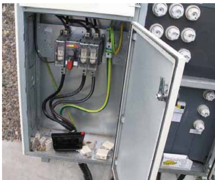
Kuva 7. Keskuksen kennoissa säilytetään vaarallisesti varasulakkeita.
