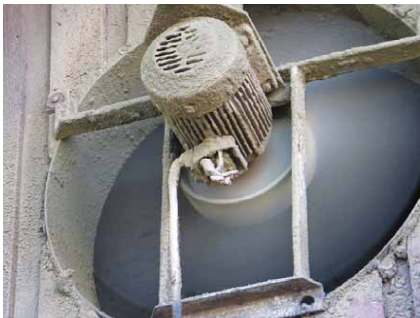
Kuva 5. Erittäin likainen sähkömoottori ja avoin kytkentäkotelo.
