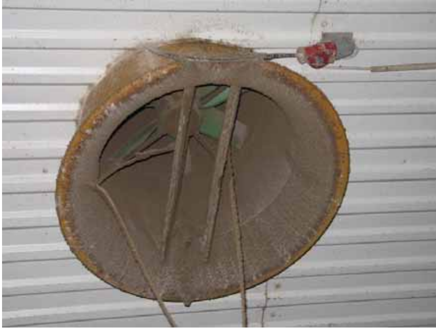
Kuva 10. Pistotulppaliitäntäinen laite tuotantotilan katossa.
