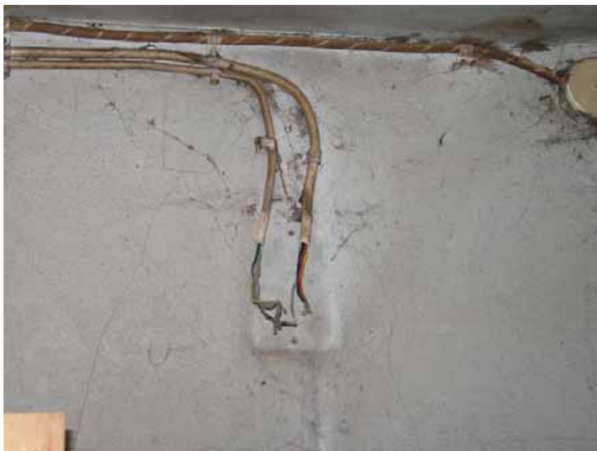
Kuva 17. Vanhoja käytöstä poistettuja kaapeleita tuotantotilan seinällä.
