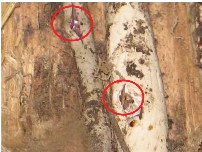
Kuva 16. Paljaita jännitteisiä osia asennuskaapelissa.
